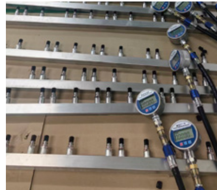
▲ 快装接头款-AI液冷数据中心主管路
