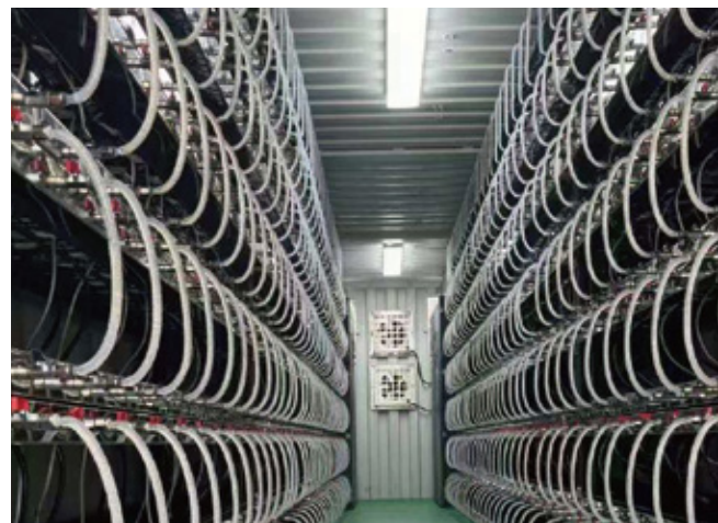
▲ AI液冷数据中心现场运行调试
